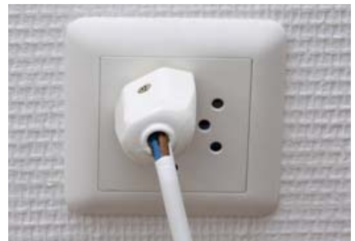
Bild 22: Defekte Elektrokabel umgehend ersetzen.
