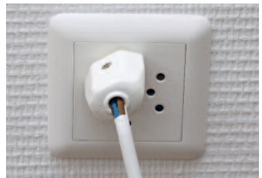
Figure 22: remplacer immédiatement les câbles électriques défectueux.
