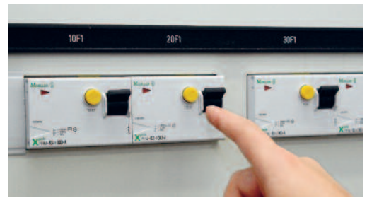
Figure 20: les systèmes de protection contre les défaillances de courant sont impératifs en milieu humide et aqueux.
